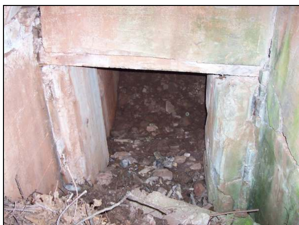
▲ [5018757] Der Durchgang vom rechten Eingangsbereich in die Gasschleuse: Links und rechts sind die Halterungen für den Panzertürrahmen zu sehen.
