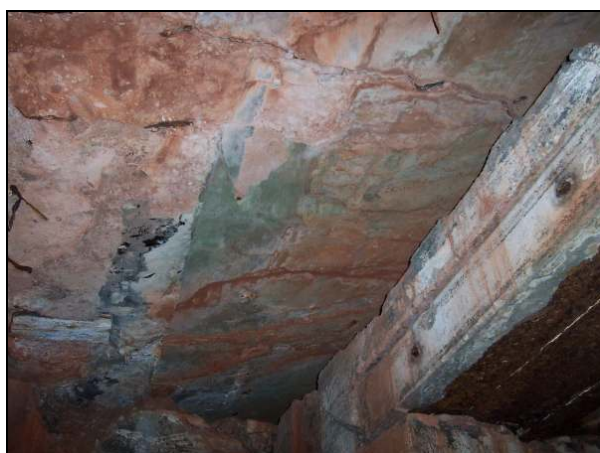
▲ [5018758] Die gesamte Decke ist verrutscht: Die Decke der Hofüberdeckung liegt jetzt über der Gasschleuse.
