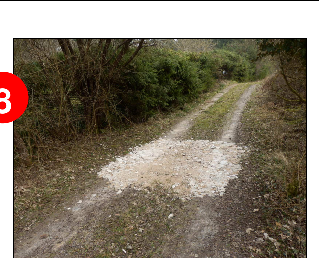
▲ [5020732] Diese werden immer wieder unter Bauschutt zugedeckt, vielleicht weil herausstehende Armierungseisen zu Reifenschäden der Anlieger führen könnten.
