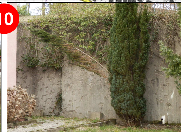
▲ [5020563] Hier sind Schäden durch Splitter und MG-Feuer erkennbar.
